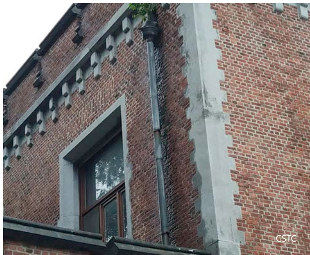
3 | Infiltrations dues à un mauvais entretien de la descente d'eau.
