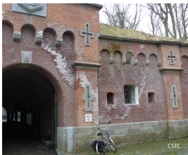
1 | Efflorescences de sels apparues lors du séchage d'un mur à la suite d'infiltrations.
