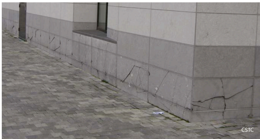
2 | Rupture des pierres due à des chocs accidentels.
