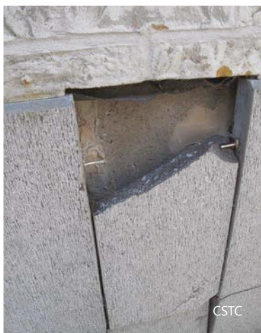
1 | Fissuration entre les ancrages.
