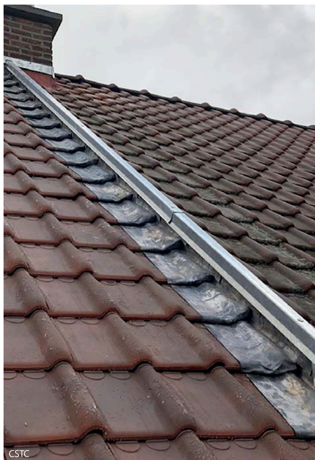
3 | Jonction entre une toiture rénovée (à gauche) et une toiture existante (à droite) à l'aide d'un tasseau.
