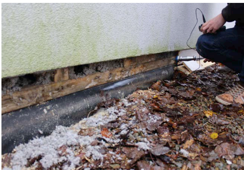
1 | Analyse des dégradations en pied de mur.
