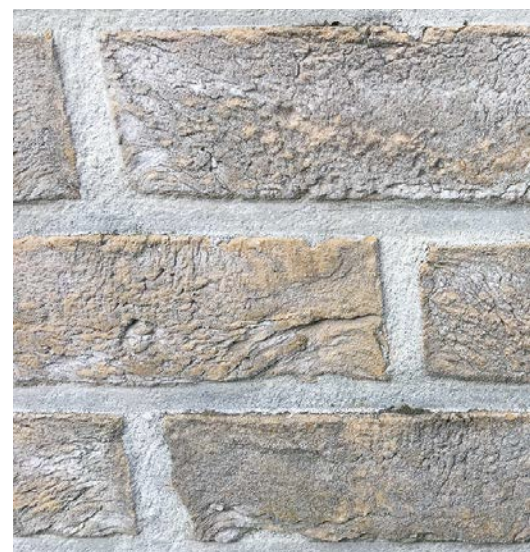
Efflorescences de gypse sur des briques.
