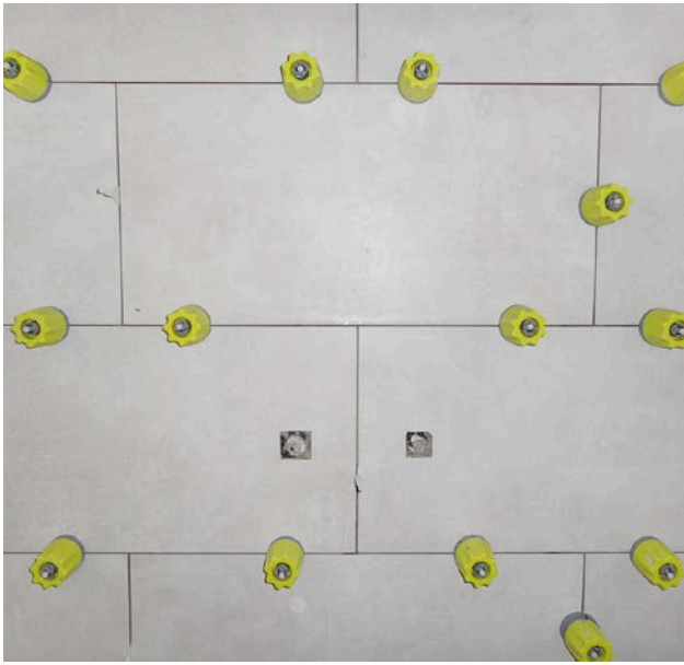
2 | Pose d'un système de nivellement constitué d'éléments de serrage sur une paroi de douche.
