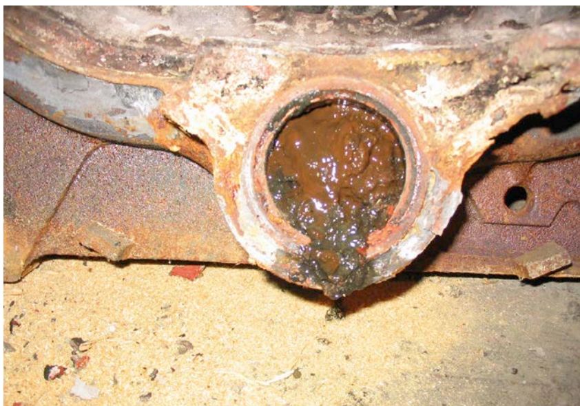
Dépôts dans une installation de chauffage.
