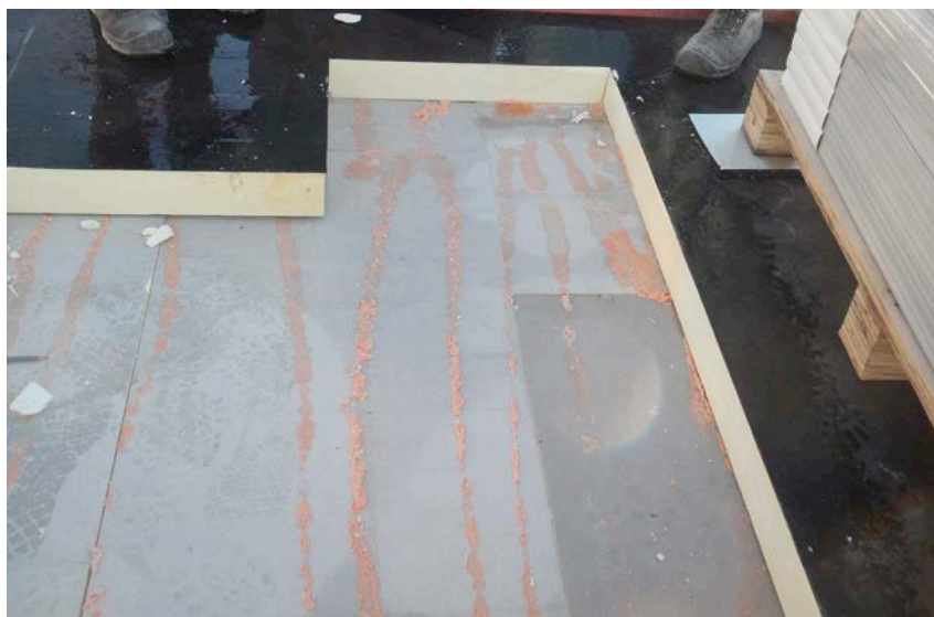
2 | La dispersion de l'humidité dans le complexe toiture rend la détection des infiltrations difficile.
