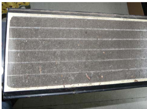
1 | Filtre d'alimentation d'un système D encrassé
