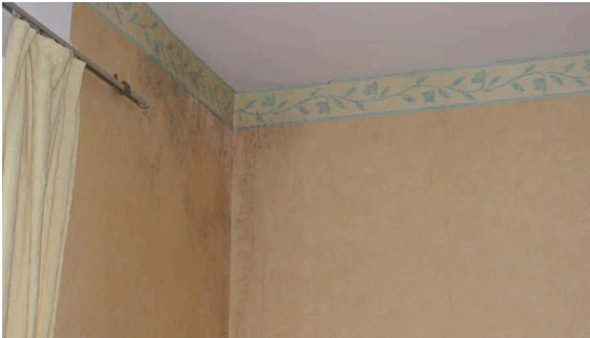
3 | Développement de moisissures sur des finitions intérieures
