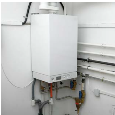
1 | Générateur de chaleur central : chaudière
