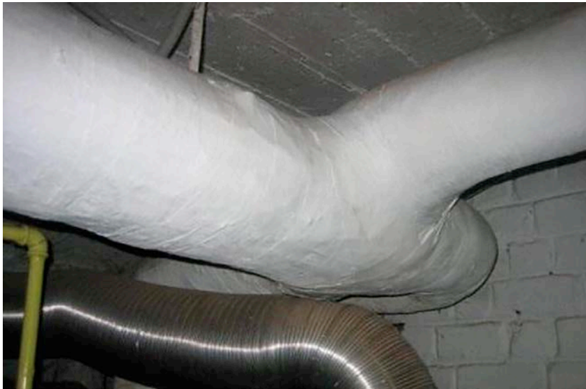
4 | La présence et l'état de l'isolation doivent être vérifiés.
