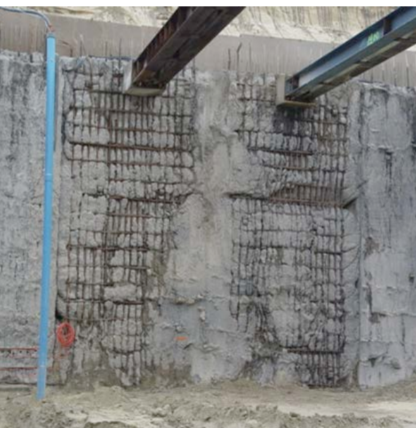
Dégâts observés sur des parois moulées
