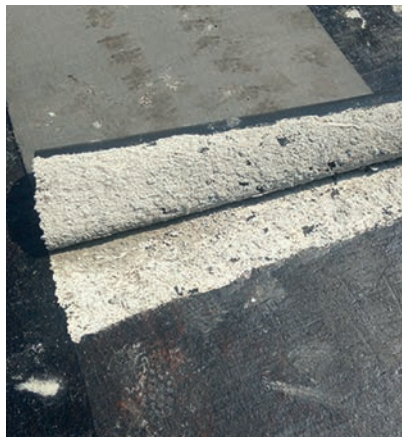
1 | Décollement de l'étanchéité à la suite d'une cohésion superficielle trop faible du béton mousse
