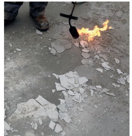
2 | Pulvérulence de la couche de surface d'une forme de pente à base de ciment
