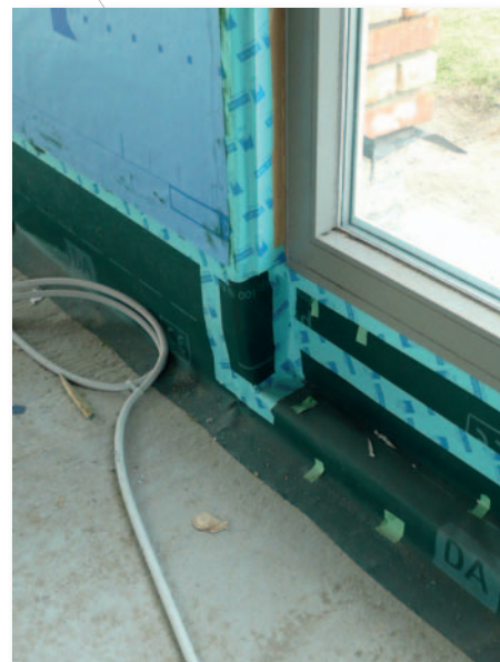
Fig. 2 Raccord entre une paroi à ossature en bois et une dalle de béton au moyen d'une membrane synthétique
