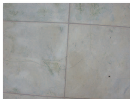
Fig. 1 Fissuration dans un dallage dont le matériau se fragilise au cours des cycles de gel/dégel
