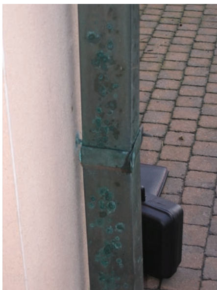
Coloration bleu-vert d'un tuyau de descente et de son collier de fixation.
