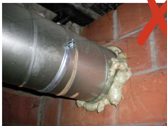
Fig. 4 En haut : les ouvertures sont resserrées à la laine de verre et non à la laine de roche; de plus, les ouvertures sont trop grandes par rapport au diamètre des câbles. En bas : resserrage non conforme (mousse) d'un conduit de ventilation; un clapet résistant au feu doit être mis en œuvre.
