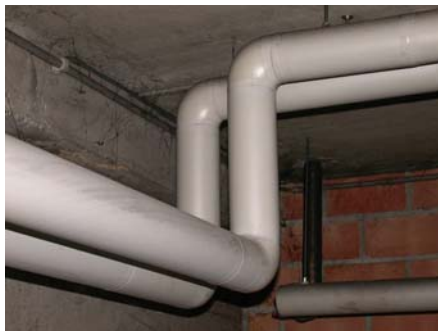
Fig. 1 Isolation thermique des tuyauteries situées hors du volume protégé.
