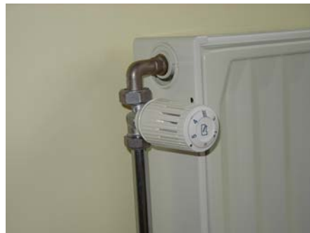
Fig. 2 Vannes thermostatiques : une solution simple pour le réglage de la température dans chaque local.
