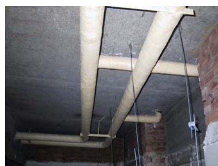
Fig. 2 Calorifugeage de tuyaux.
