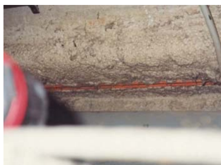
Fig. 1 Plafond floqué à l'amiante.
