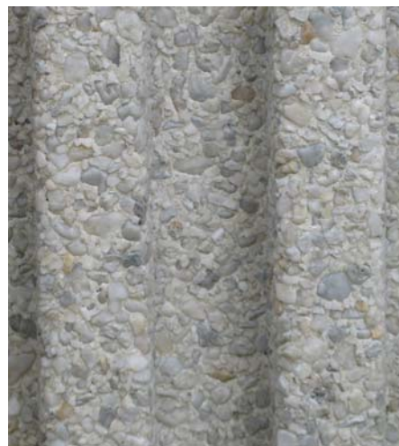
Fig. 2 Teinte plus claire : les granulats foncés sont recouverts de sels blanchâtres.
