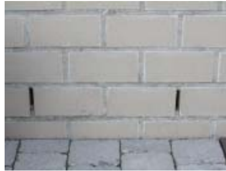
Fig. 2 Joints verticaux insuffisamment ouverts.
