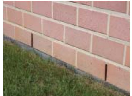
Fig. 3 Joints verticaux ouverts jusqu'au niveau de la membrane sous-jacente (qui devrait idéalement déborder du mur).
