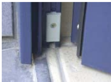
Fig. 1 Positionnement incorrect du seuil de porte : la butée de la plinthe à guillotine est située en retrait du talon du seuil.
