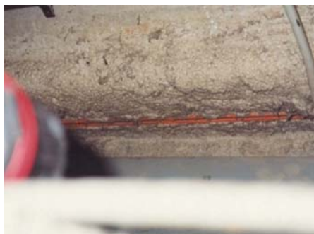
Abb. 1 Decke mit Spritzasbest.
