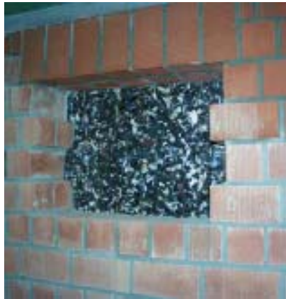
Vue éclatée dans un mur de cave, montrant le drainage réalisé avec des déchets de polyéthylène déchiquetés placés sur un géotextile; mur en blocs de terre cuite contenant des boues de sciage de pierres calcaires et de la sciure de bois.
