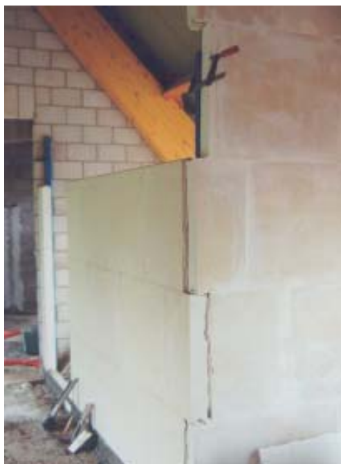
A l'étage : cloisons intérieures réalisées à l'aide de carreaux à base de phosphogypse et de sulfogypse.
